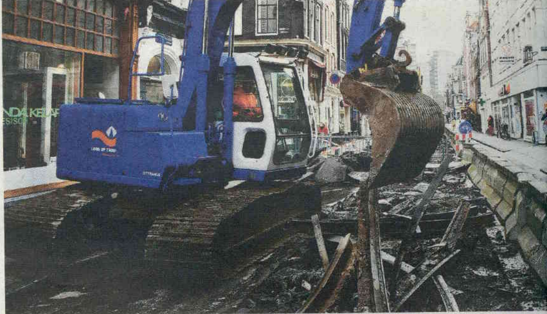
In de Utrechtsestraat worden dit jaar onder andere de sporen en de fundering van de weg vernieuwd.
